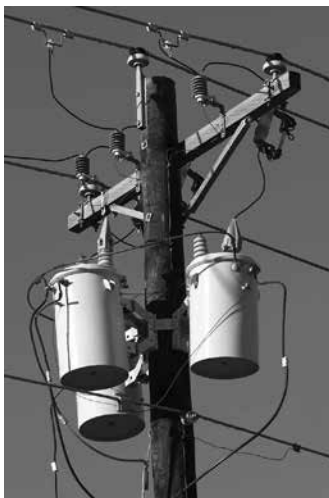
Tři transformátory na sloupu nadzemního elektrického vedení distribuční soustavy
